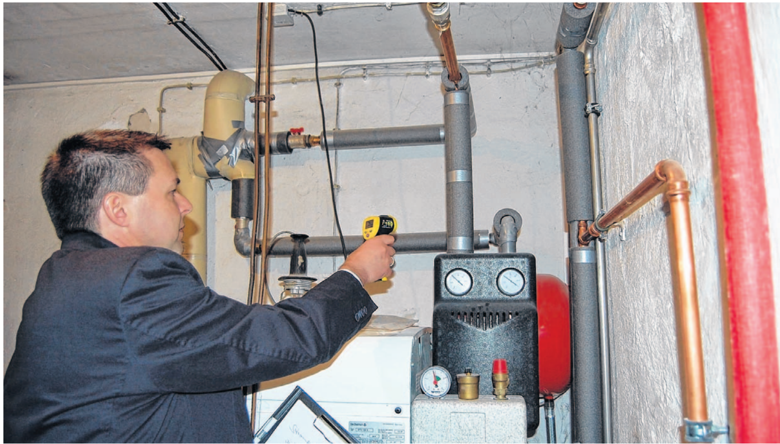
Beim Gebäude-Check der Energieagentur Main-Tauber-Kreis nimmt Geschäftsführer Frank Künzig auch die Heizung genau unter die Lupe.
